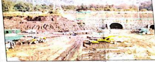
जड़पिकेश-कर्णप्रयाग परियोजना की निर्माणाधीन टनल जो पानी पहले दोगी पट्टी के ऊंचाई वाले क्षेत्रों में घसमें के रूप बाहर आता था, वह पहाड़ी के
